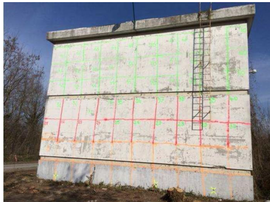
Figure 11 : Bâtiment DTE mur
