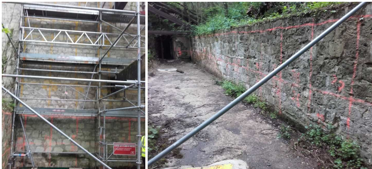
Figure 4: murs PH gauche (mur 1 à gauche et mur 2 à droite)
