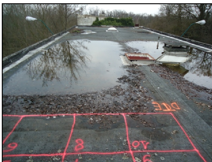
Figure 7 : toiture à zones inondées et/ou d'accès dangereux
